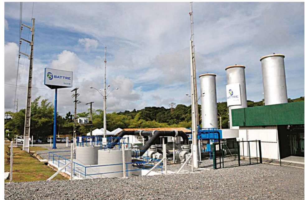
Exemplo de sistema de tratamento de biogás
